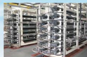
Filtration de l'eau potable
